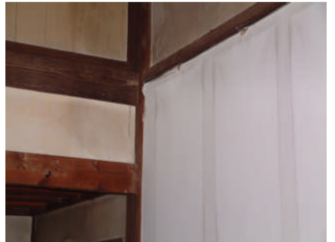
内陣の東側、左上の壁が緩んでいます。
